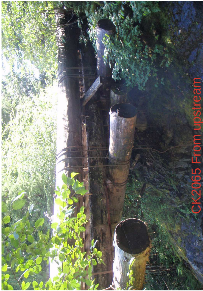
CK2065 Rotten cross tie 2
